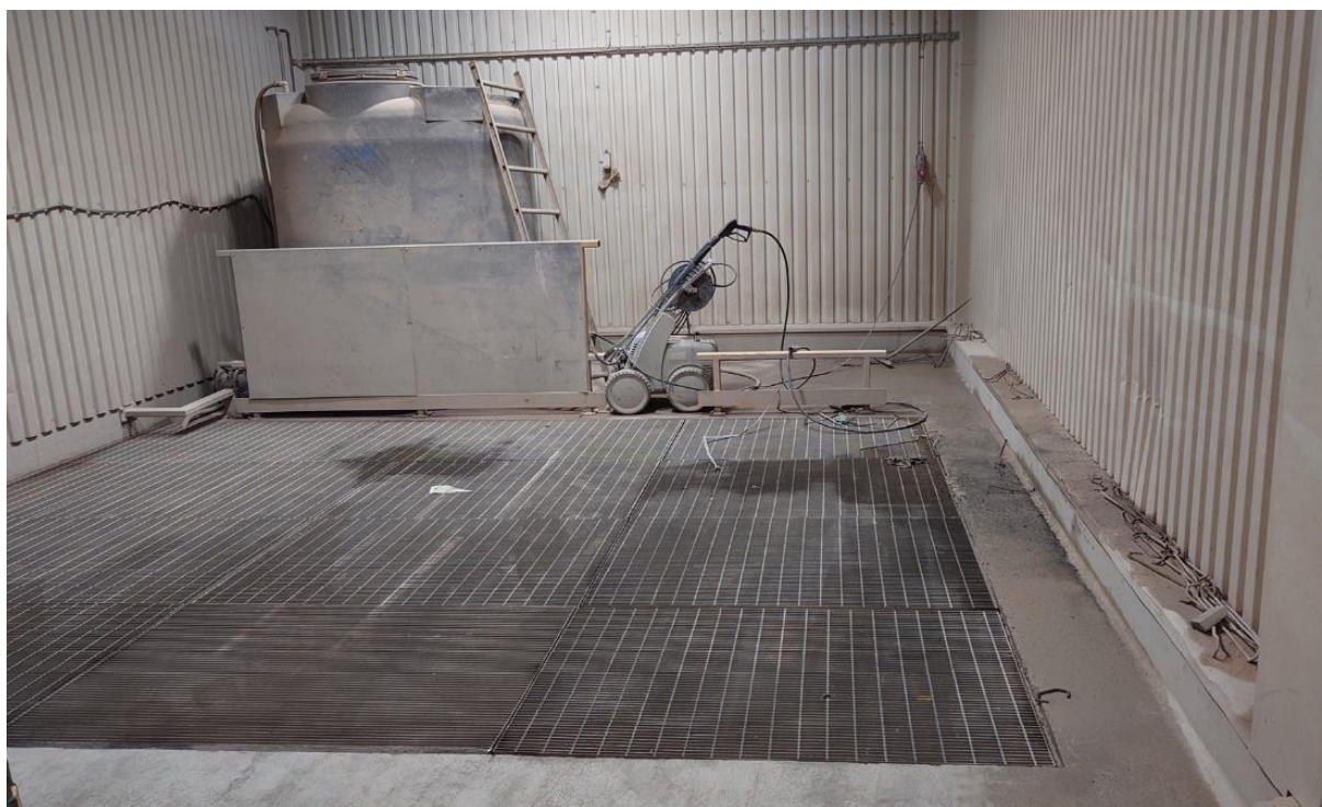
Figur 7 Exempel på spolplatta där metallgodset tvättas av med högtryckstvätt.
